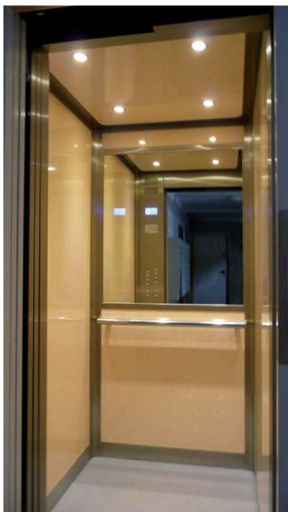
Fot. K. Kisiel Kabina dźwigu z zastosowaniem oświetlenia LED i zaawansowanego sterowania
